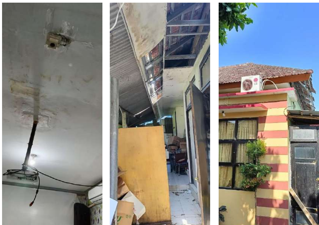
Survey Analisa Kerusakan Bangunan pada Puskesmas Tekung
