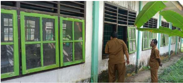
Survey Analisa Kerusakan Bangunan SMAN 1 Klakah
